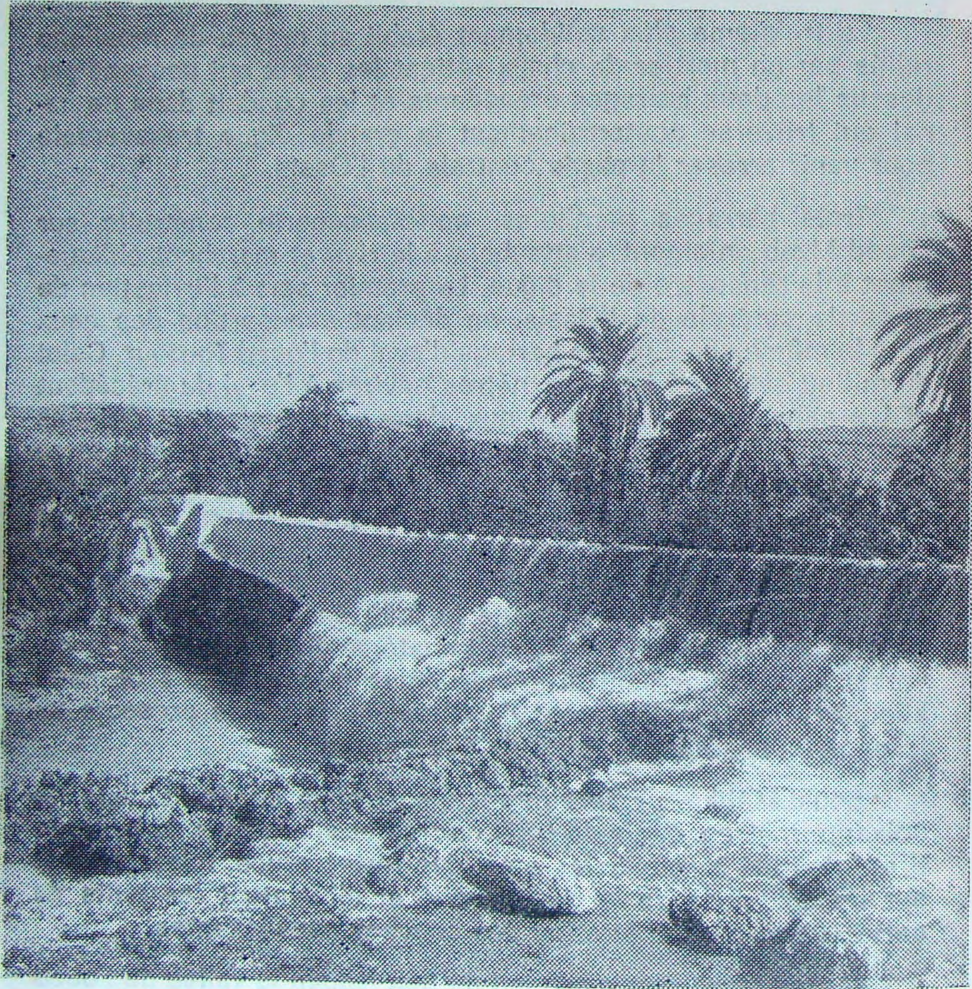
Ancien barrage, servant à l'irrigation et au partage des eaux lors des fortes crues
