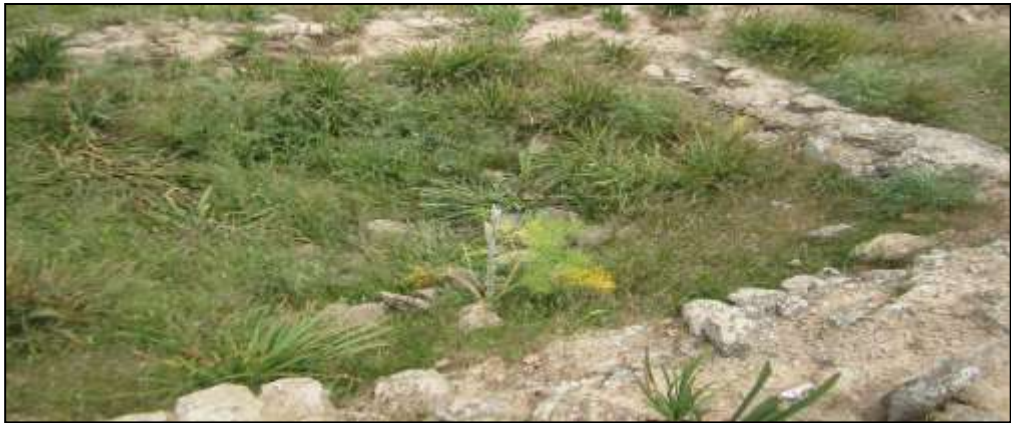
لوحة رقم (22): بقايا الغرفة الشرقية من الواجهة الشمالية للقصبة -من إعداد الطالبة-
